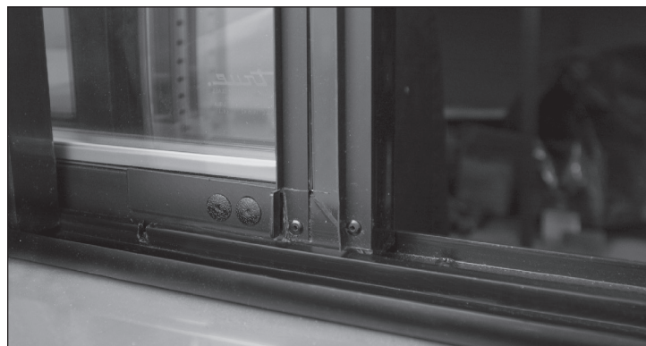
Fig. 2. La serratura dello sportello è in posizione chiusa (disinnestata dall'incavo).
